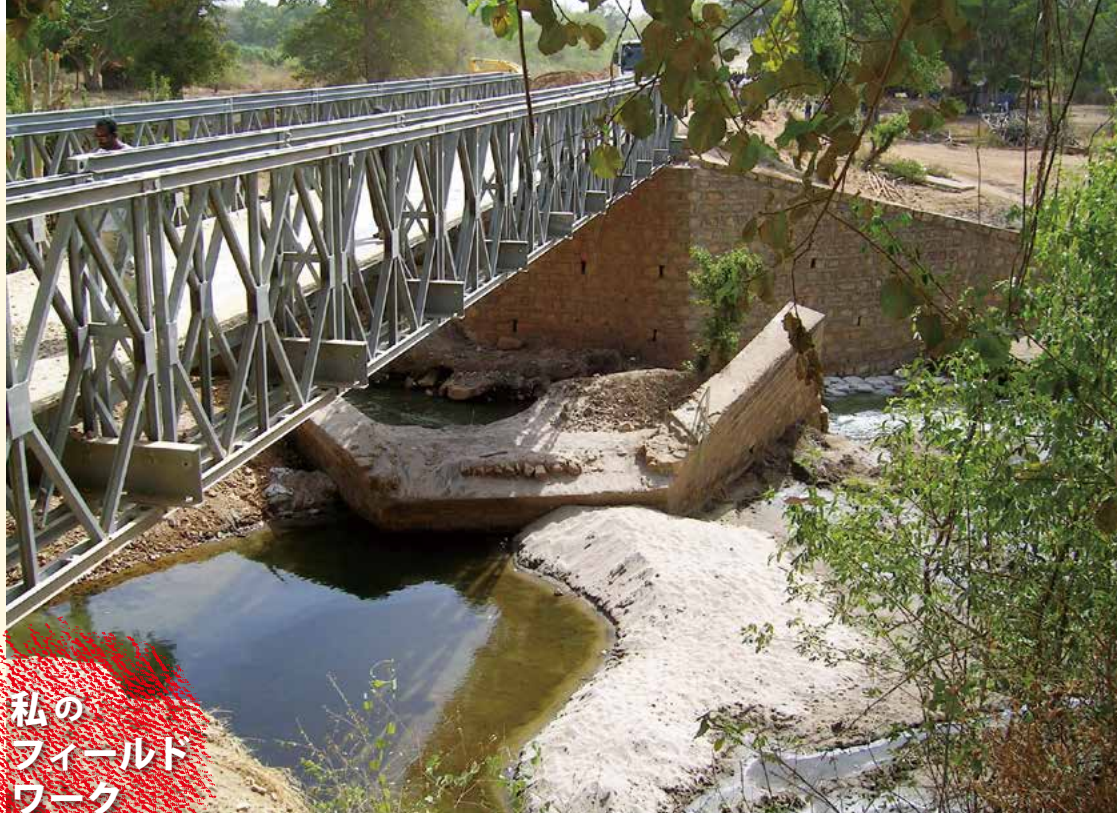
橋が落ちたので仮橋を バスが渡ります。
